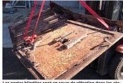
Les portes blindées sont en cours de réfection dans les ateliers des services techniques municipaux. © Gramasa
